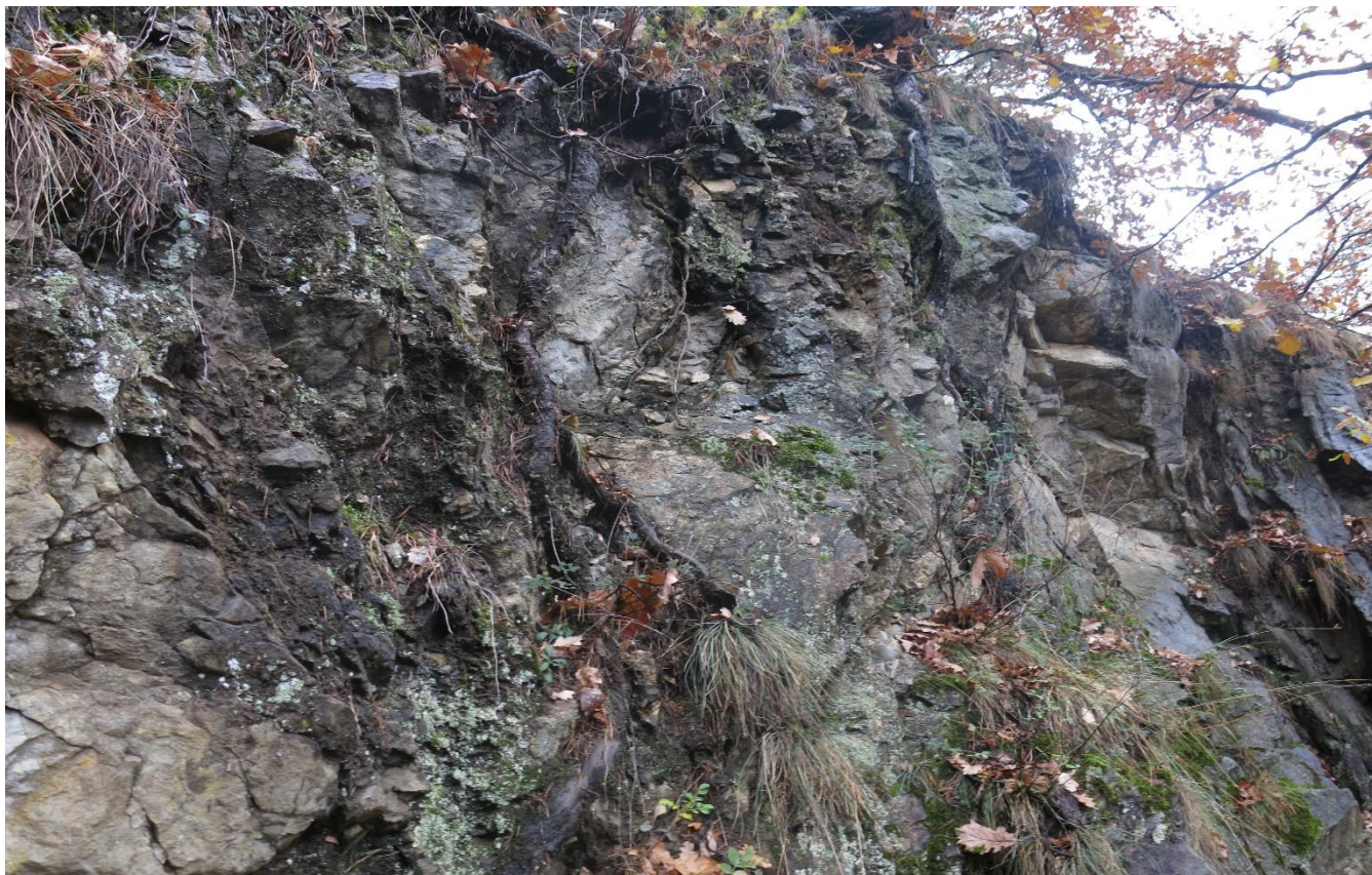
Prorůstání kořenového systému do puklin horniny
