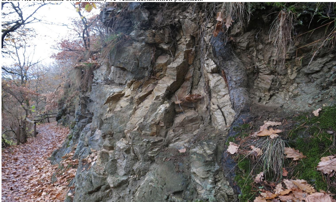
Část skalní stěny z které prokazatelně v minulých letech došlo k usmýknutí bloků horniny na přilehlou stezku.
