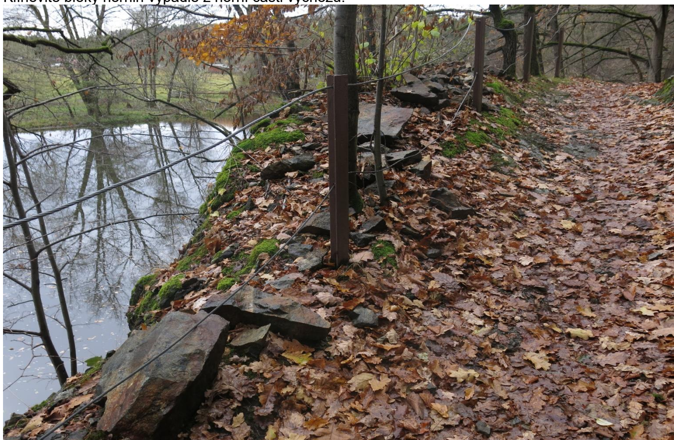
Vypadlé bloky horniny směrem k patě výchozu. Po odklizení z pěšiny.
