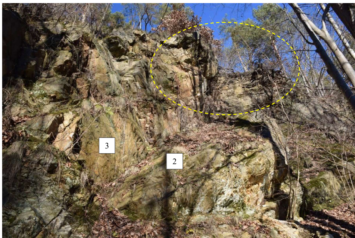
Foto 5 Místo skalního řícení z roku 2016. Pravděpodobná odlučná oblast je vyznačena žlutou elipsou . Čísly jsou ve fotografii vyznačeny hlavní systémy diskontinuit shodné s čísly na obrázku 3, které se mohly podílet na skalním řícení s možným primárním porušením typu vyjždění horninových klínů nebo planární porušení sjížděním po předurčené ploše.
