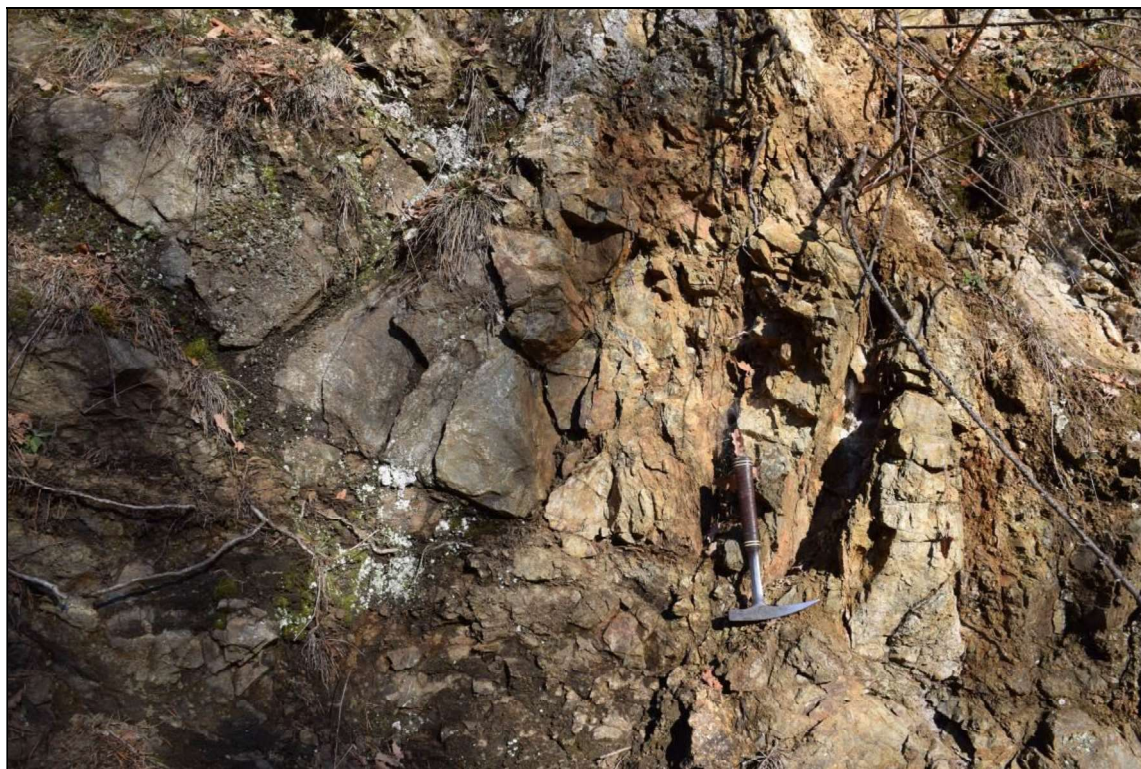
Foto 9 Charakter tektonicky více porušených a silněji zvětralých nestabilních partií ve skalních stěnách. Jednotlivé nestabilní kusy horniny lze ze stěny snadno vylamovat rukou.
