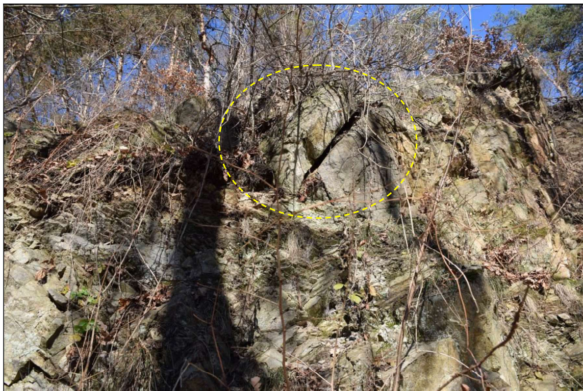
Foto 7 Lokálně se ve skalních stěnách objevují i větší nestabilní horninové bloky velikosti i více než 1 m (zvýrazněno žlutou elipsou).
